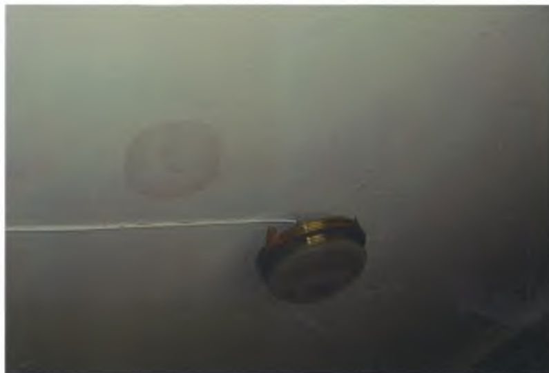
Fuktros i papptak i rum på övre våningen. Vlm_kmvLS-626
