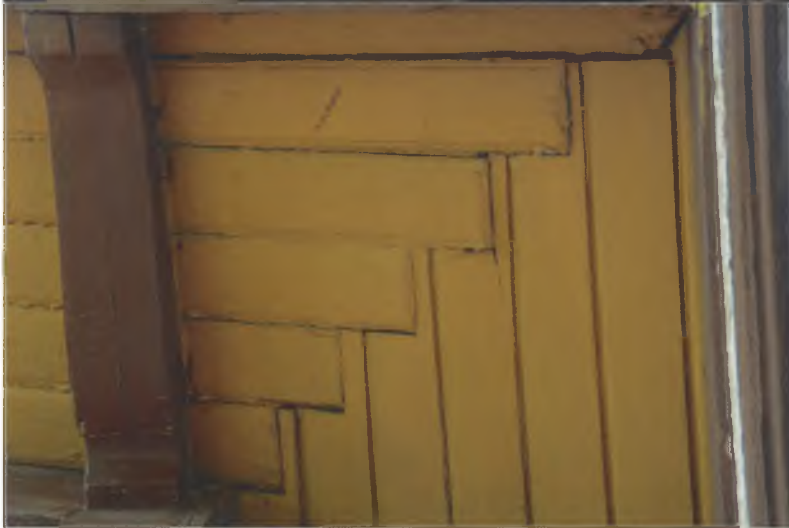
Tidigare utbytta undertaksbrädor i takfoten på södra takfallet. Lagningar utförda då byggnaden fortfarande var i SJ's ägo. Vlm_kmvLS-1971
