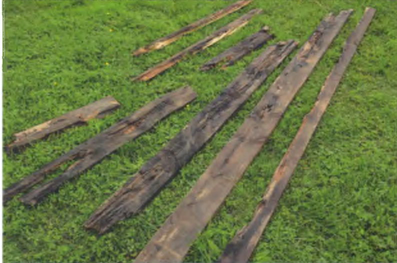
Rötskadade undertaksbrädor. Vlm_kmvLS-1970
